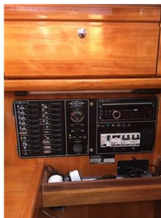
bavaria 30 quadro e
